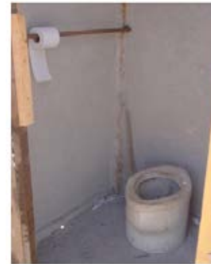
Baños secos - vista interior
